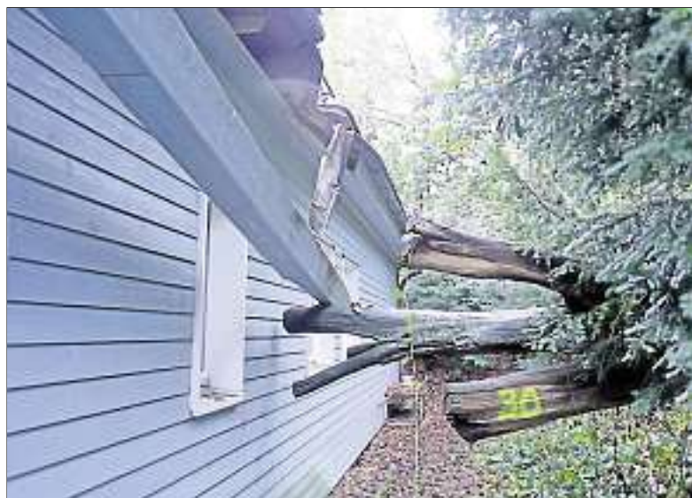
Dieser umgestürzte Baum hat das Dach des Schwimmbads beschädigt.
