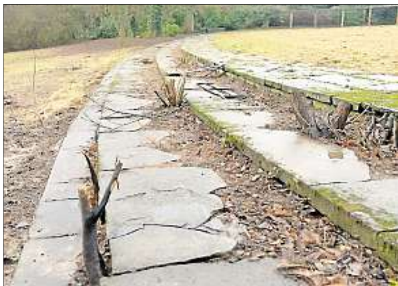
Pflanzen haben sich durch die Treppe ihren Weg gebahnt.
